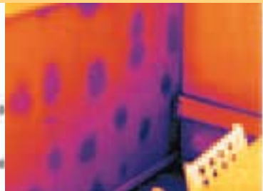
Humedades en muros
