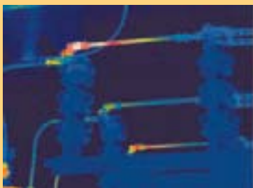
Oxidación de los conmutadores de alta tensión
