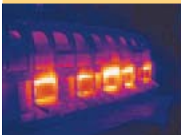
Defecto de aislamiento
