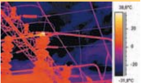
Conexiones de alta tensión defectuosas
