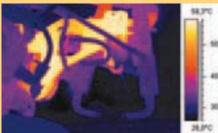
Puntos calientes en robots de soldadura
